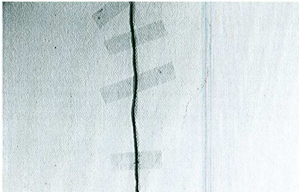
Mur face du séjour non dégradé La fissure se trouve en dessous de la toile de verre
